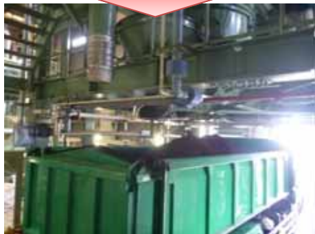
図 焼却灰トラック輸送
