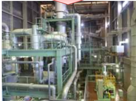
図 下水汚泥焼成プラント
